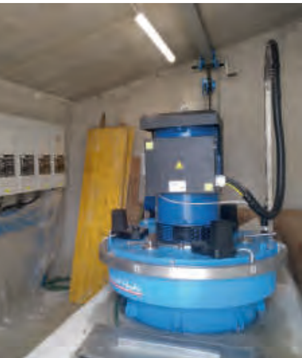
Centralina installata al rifugio Saènt Silvio Dorigoni foto Commissione Rifugi SAT
